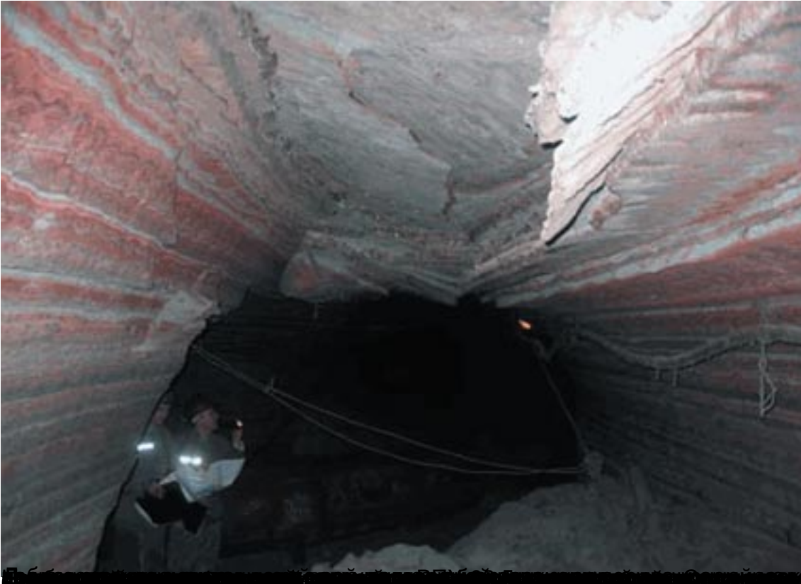
Рис. 1. Проверка состояния обделки шахтного ствола с помощью датчика акустической эмиссии
